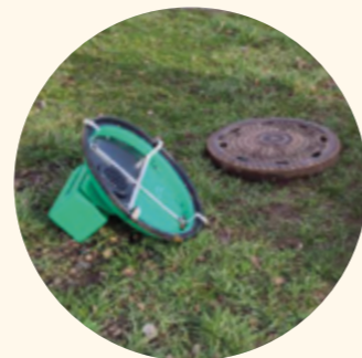
→ Dank eingebauter Geruchsverschlüsse sind die Brauereigerüche in Kleinpestitz nicht mehr so stark.
