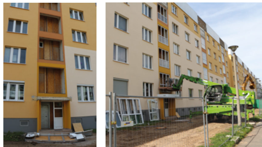
→ Ebenfalls werden an der Rungestraße 9 – 27 Aufzüge angebaut und anschließend die Außenanlagen neugestaltet.
